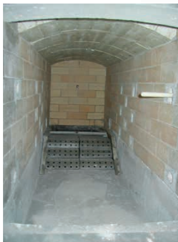
Foyer chaudière à gradins mobiles
