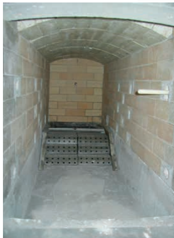
Foyer chaudière à gradins mobiles
