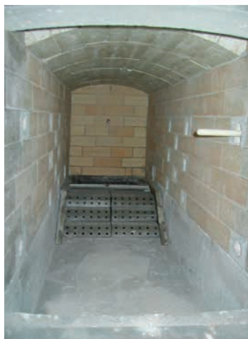
Foyer chaudière à gradins mobiles
