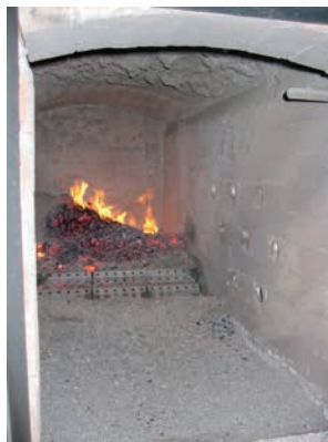
Foyer de la chaudière
