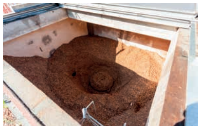
Silo de stockage de plaquettes
