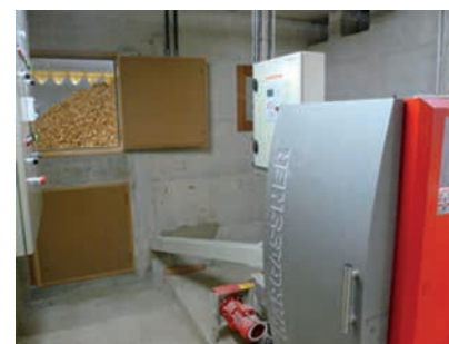
Chaudière Hargassner 45kW alimentée par une vis sans fin
