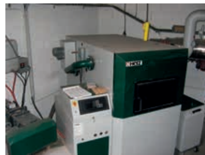
Chaudière HERZ 250 kW
