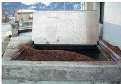
Silo enterré et son système d'ouverture
