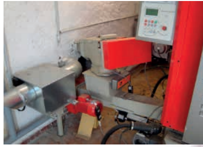
Local chaufferie et système de transfert des plaquettes
