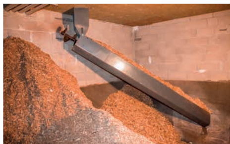
Vis sans fin de remplissage du silo
