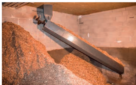
Vis sans fin de remplissage du silo
