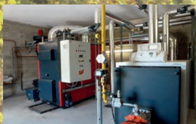
Réseau de Chaleur Arles-sur-Tech
