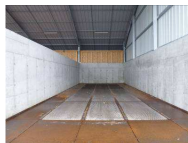
Figure 4 : Vue d'ensemble d'une cellule de séchage avec Caillebotis
