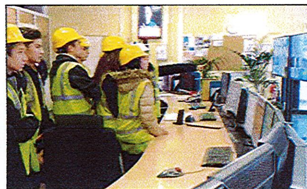
► Devant les écrans de contrôle de l'Unité de Traitement et de Valorisation Énergétique et Centre de Tri de Calce. Photo E.C.
